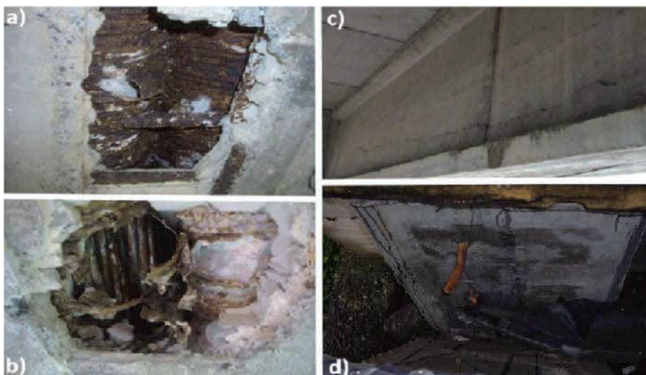
Figura 2: Gërryerja e përbërësve të çelikut, fijeve (a), mbështjellja metalike (b); gjendja e betonit (c); tuba shfryrës të pa vulosur (d).
